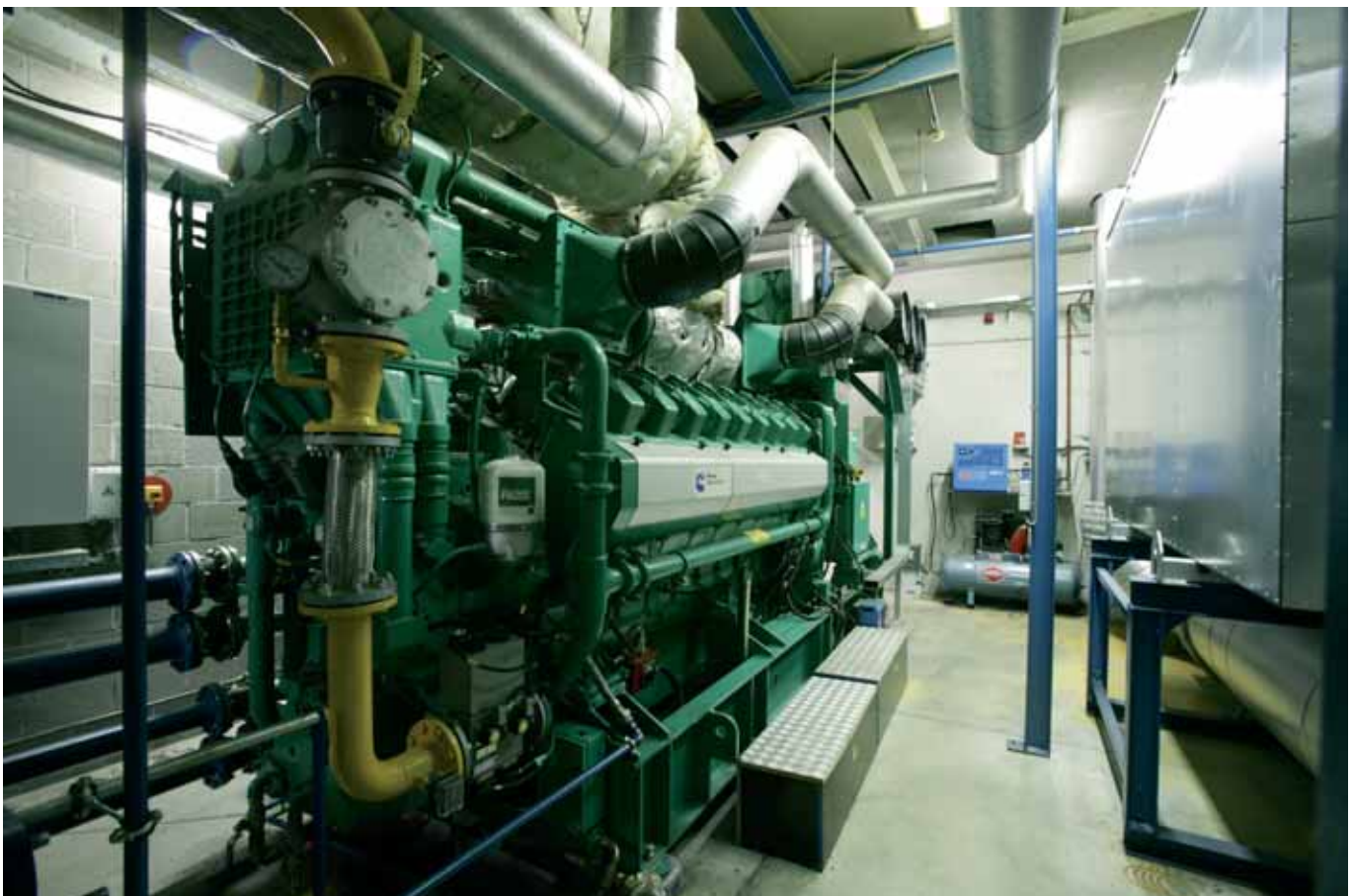
De bouw en uitbating van de warmtekrachtkoppeling zijn gebaseerd op een ongebruikelijke samenwerking.
